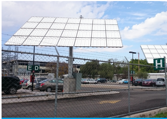
Concentradores Solares, TRIARA (TELMEX).
