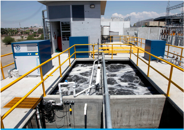
Planta de tratamiento, TRIARA (TELMEX).
