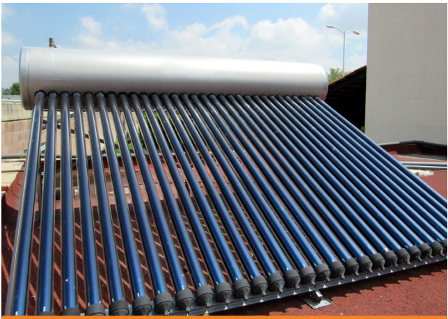
Calentamiento solar de agua, CONDUMEX.
