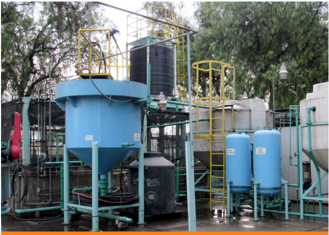
Planta de tratamiento, LATINCASA (Grupo CONDUMEX).
